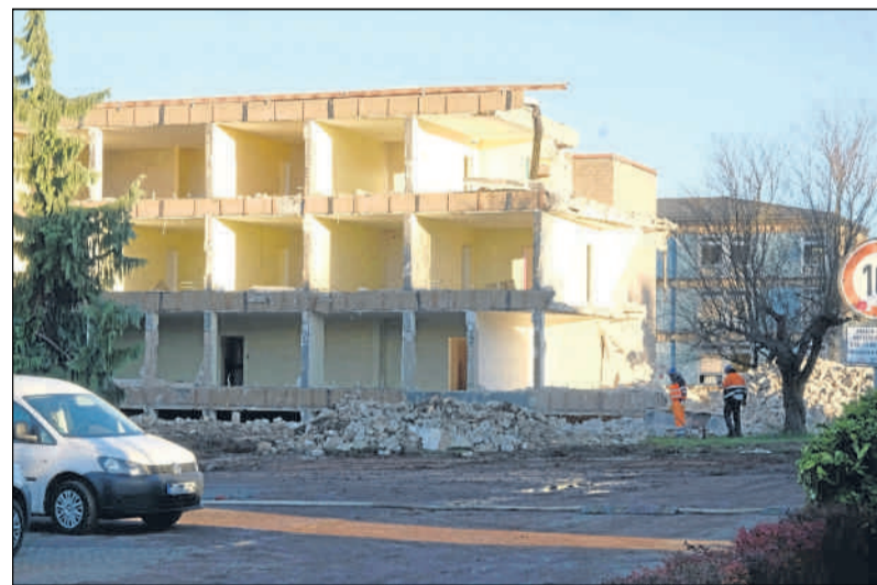
Nach und nach machen Baumaschinen die Internatsgebäude des früheren Vinzenz-Pallotti-Kollegs dem Erdboden gleich.
